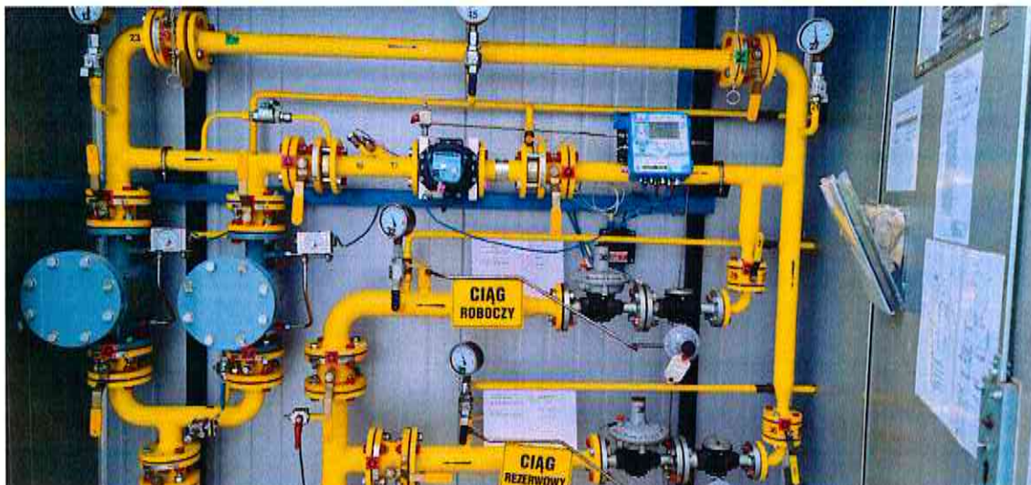
Rozdzielnia gazu na budynek IT i IT1
