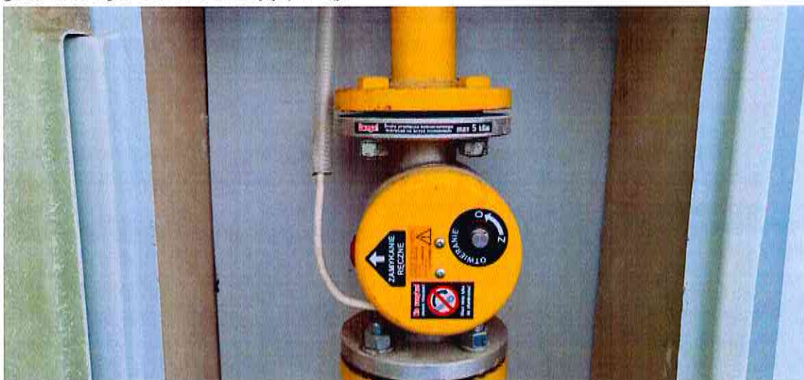
Zawór odcinający MAG umieszczony w wentylowanej skrzynce przyłącza gazu ziemnego
